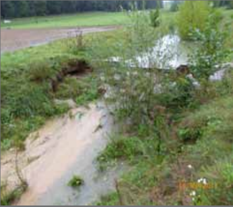
▲ Problemstelle an der grösseren Mauer
